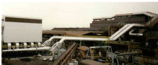
直流電気炉集塵設備
