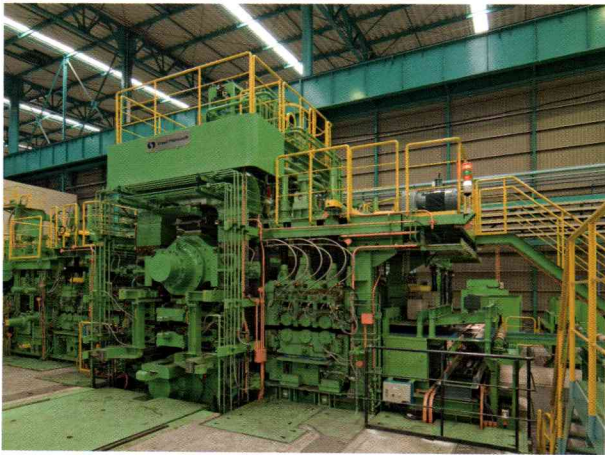
新設したNo.2スキンプスミル
