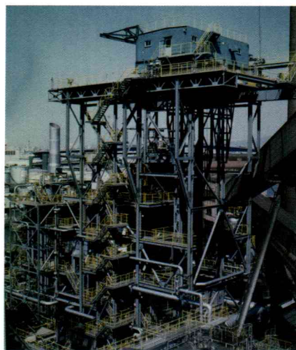
コークス乾式消火設備(CDQ)
