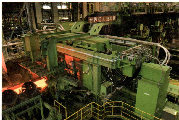
導入したエッジヒーター
