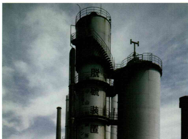
コークス炉ガス脱硫設備
